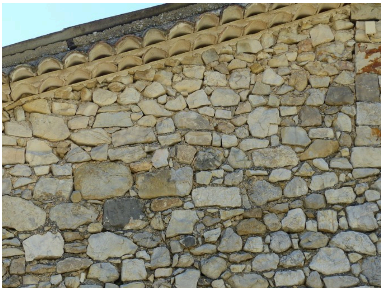
Maçonnerie d'une ferme, au quartier du Moulin. Traces de surélévation et collage.
