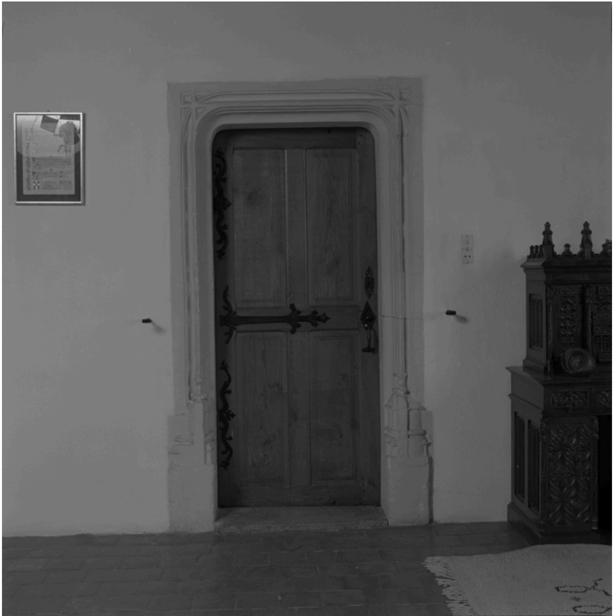
Porte de communication entre la grande salle et le réfectoire actuel, au premier étage.
