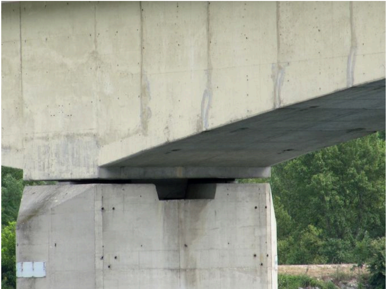
Pile, face amont, vue partielle : jonction avec la tablier (depuis la rive droite)
