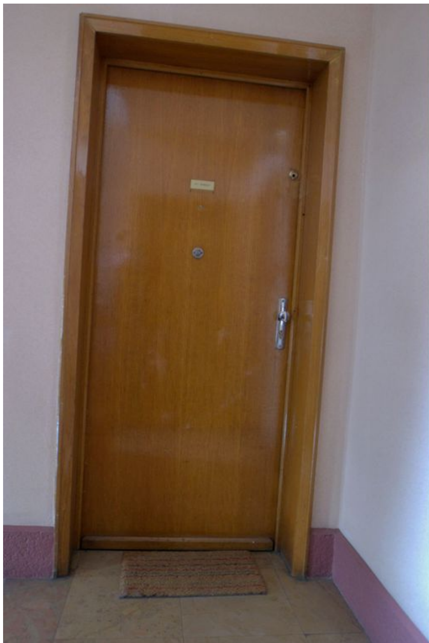
Vue d'une porte palière
