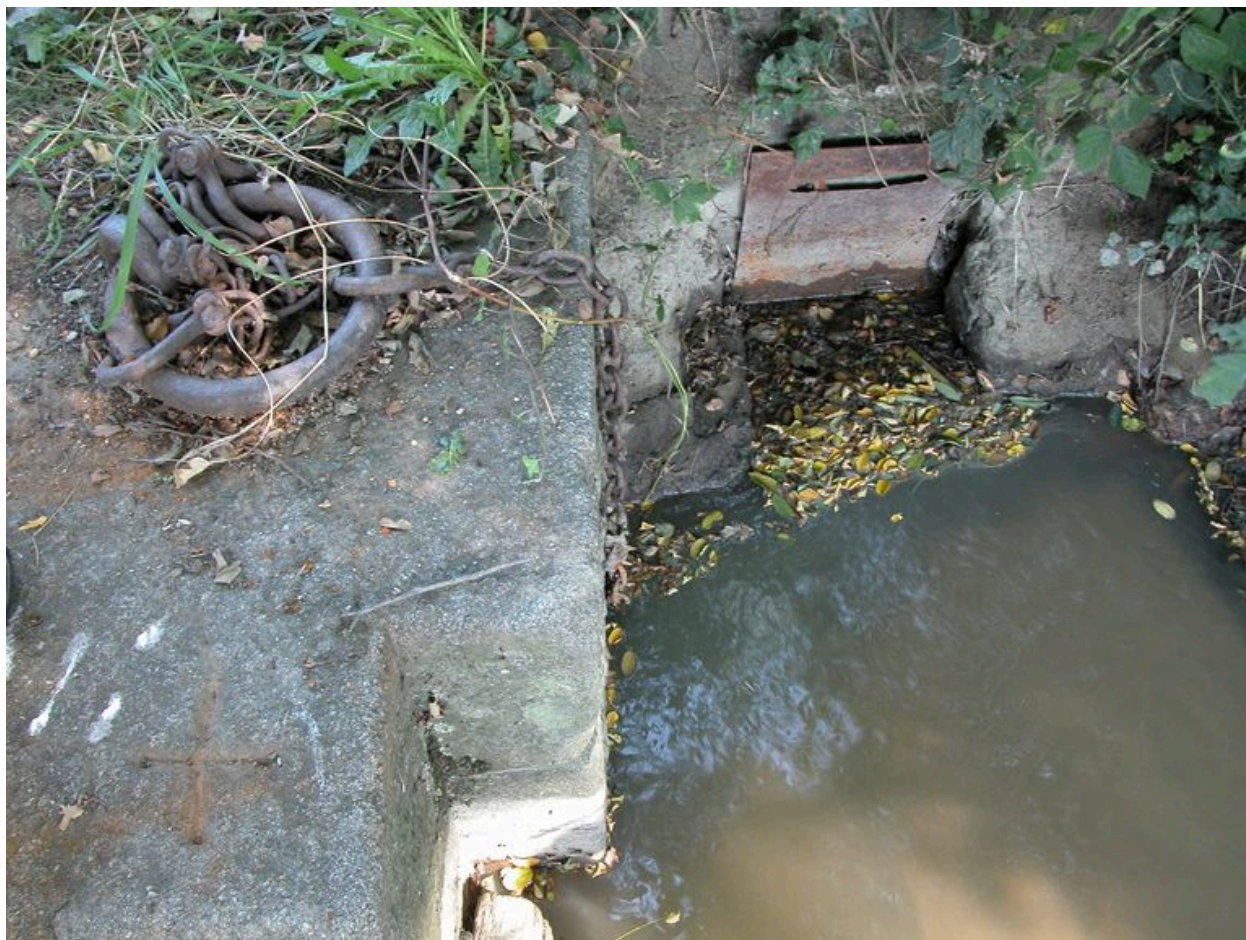
Barrage des Buissonnées (Chalain-d'Uzore, section B2). Vue d'une vanne.
