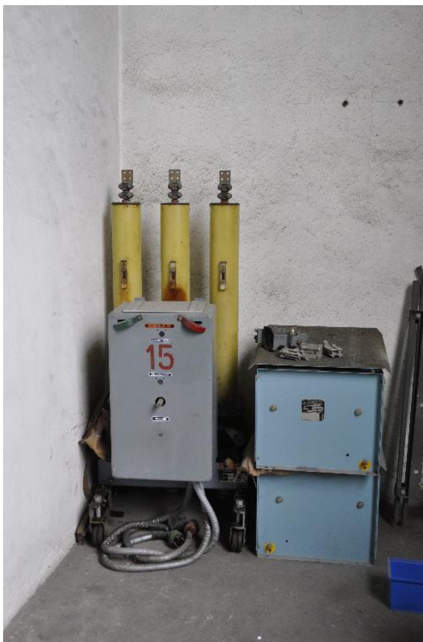
Vue du matériel électrique : disjoncteur
