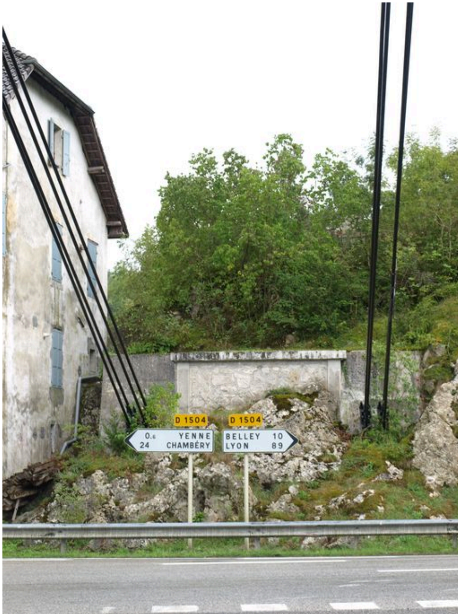
câbles et massif d'ancrage de la rive gauche, vue générale (depuis le pont)
