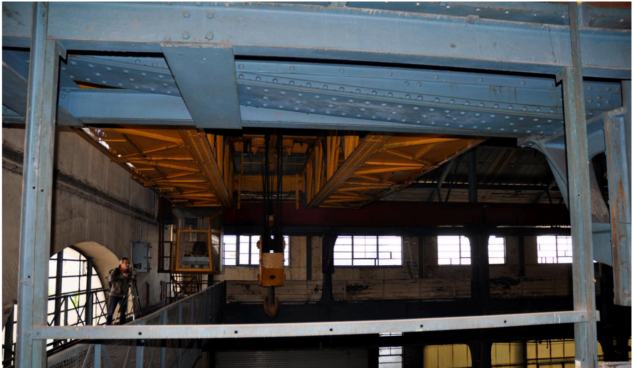
Détail pont roulant
