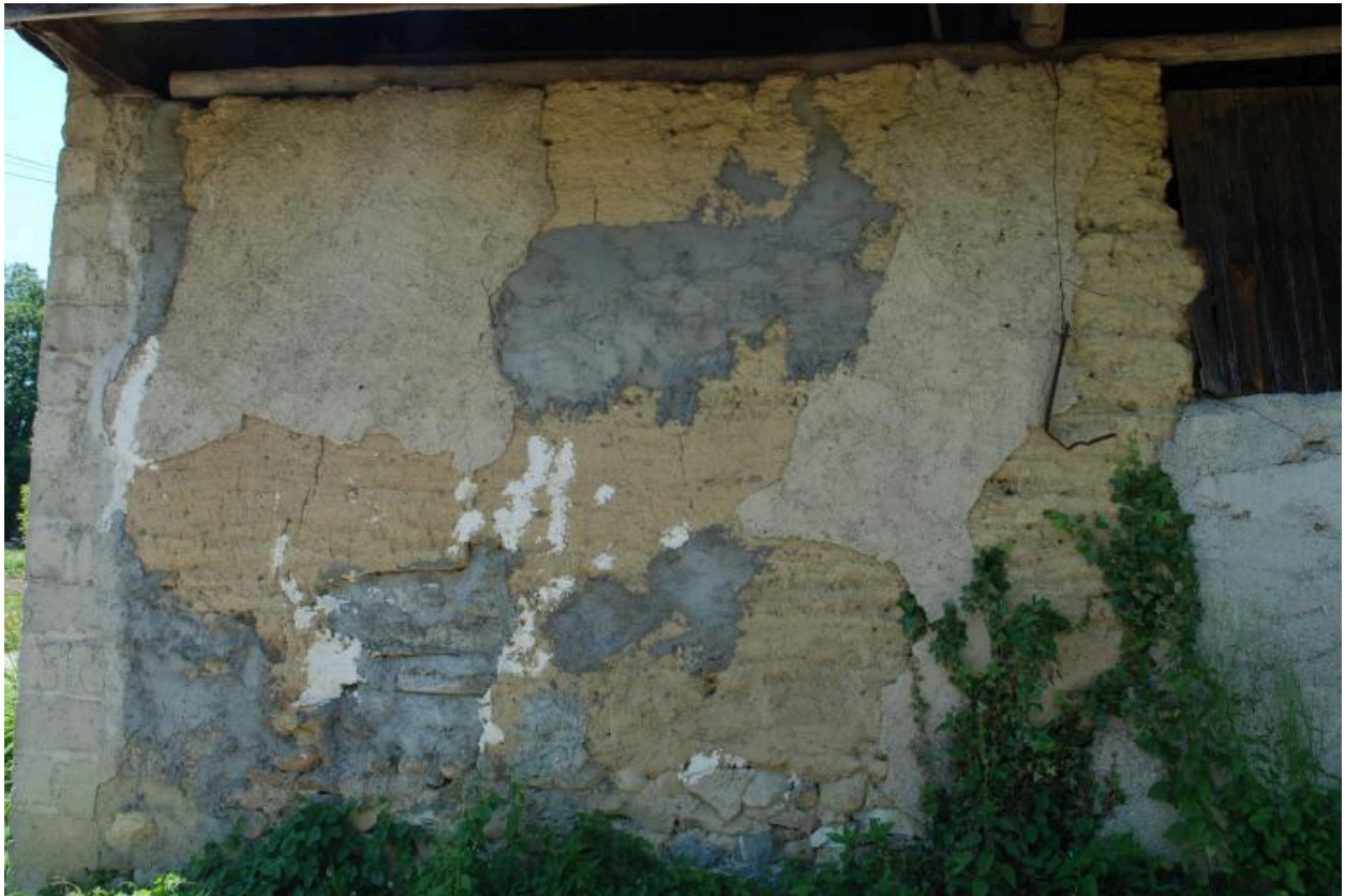
Vue arrière de la dépendance : détail du pisé.
