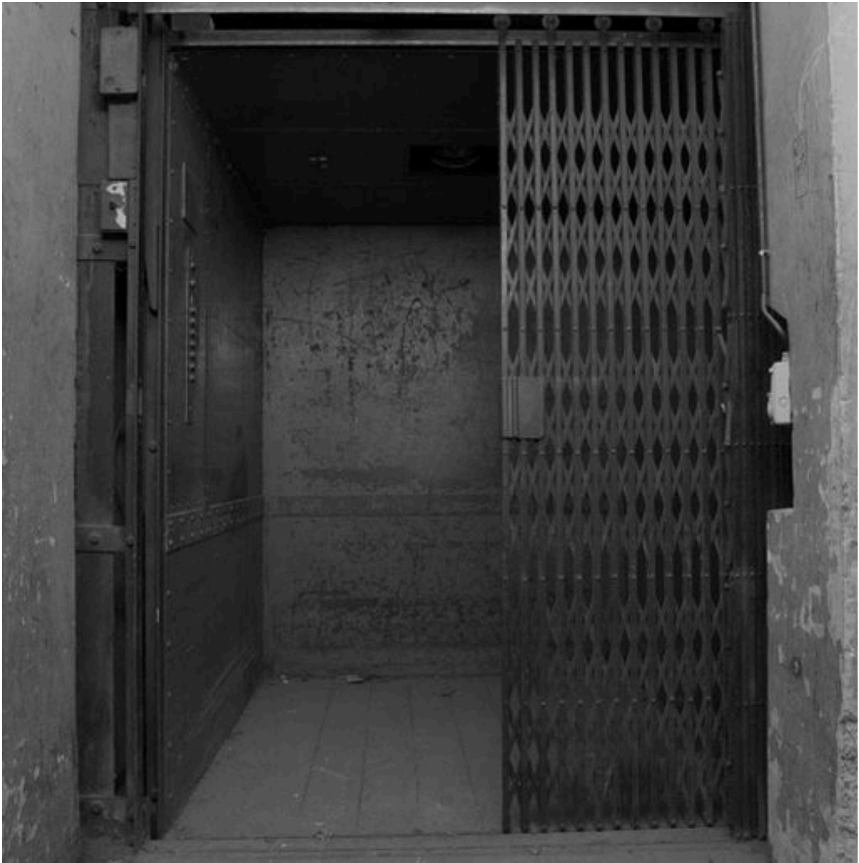
Sous-sol rue Tupin, côté rue de la République : monte-charge Otis, intérieur de la cabine
