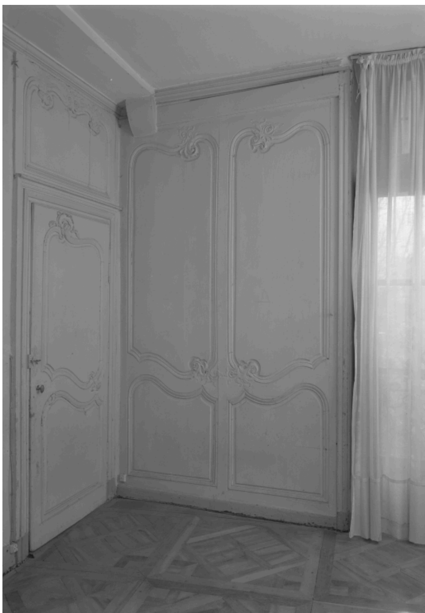
Cabinet, vue partielle.
