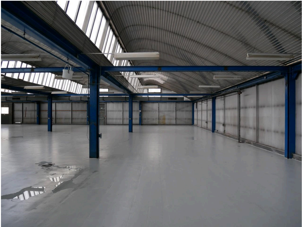
Vue intérieur : shed aluminium
