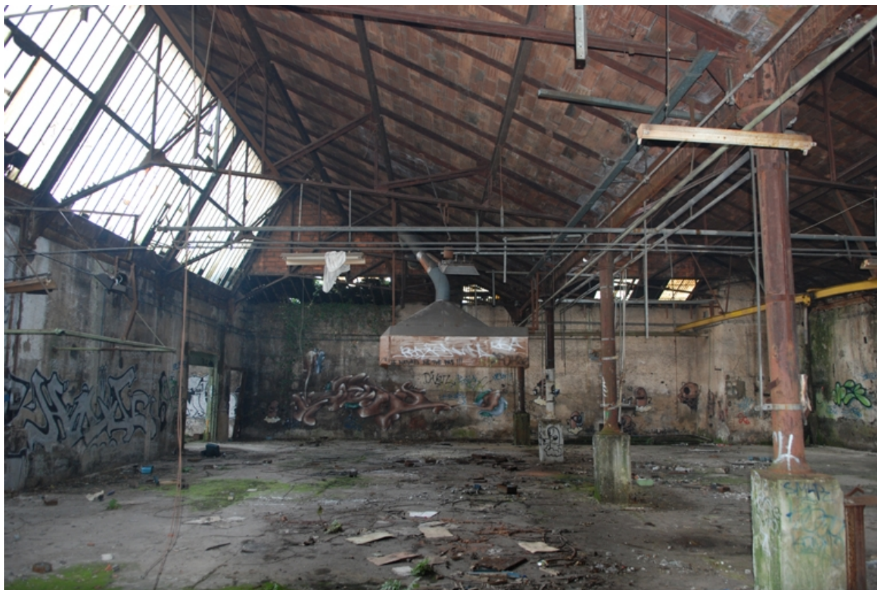
Atelier avec hotte d'évacuation
