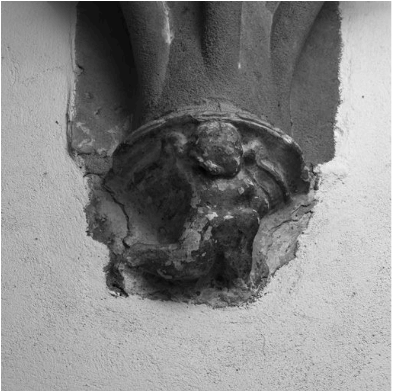
Allée 58 rue Mercière : culot n°3, putto de face ? très endommagé
