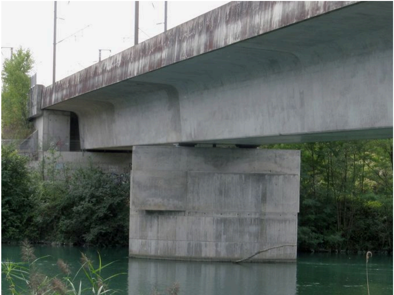
Culée de la rive gauche et pile, partie du pont sur le canal de Jonage, face amont (depuis la rive droite)
