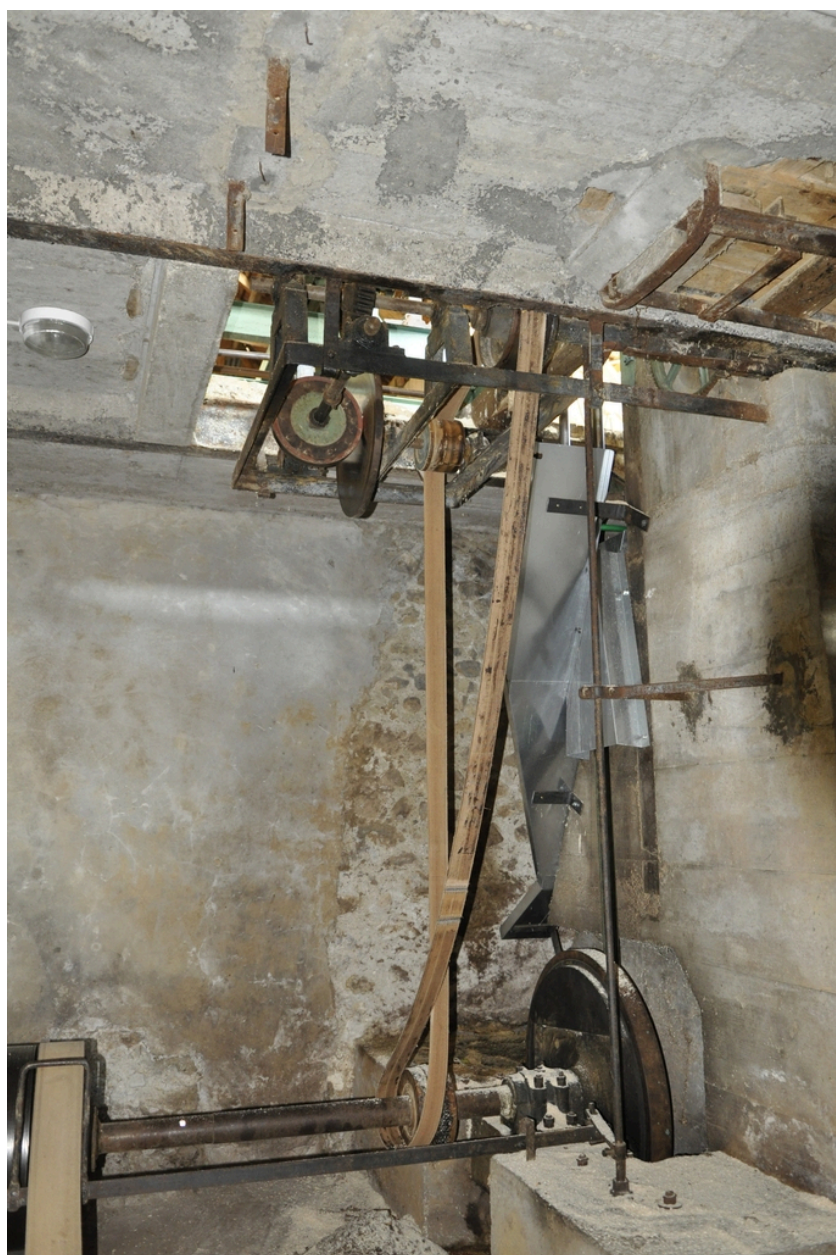
Vue du moteur électrique et des systèmes d'entraînement.
