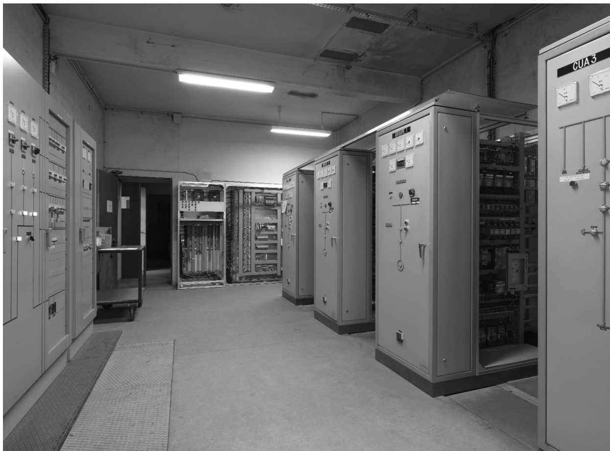
Armoires par groupe de production (cellule CUA) 1er étage
