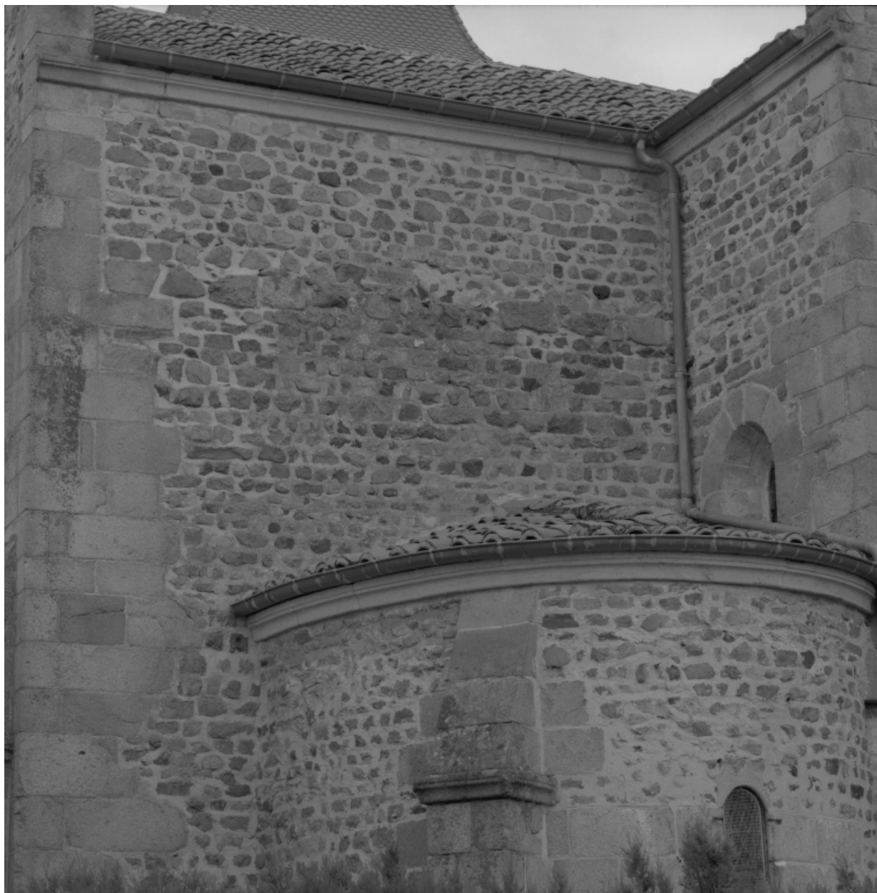
Détail du mur oriental du transept sud : ligne de rupture dans la maçonnerie.
