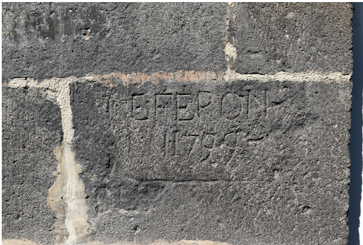
Bâtiment D, élévation sur cour : graffiti daté 1799
