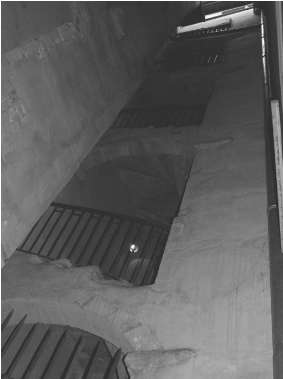
Vue en contre-plongée de la cage d'escalier ouvrant sur le côté est de la cour
