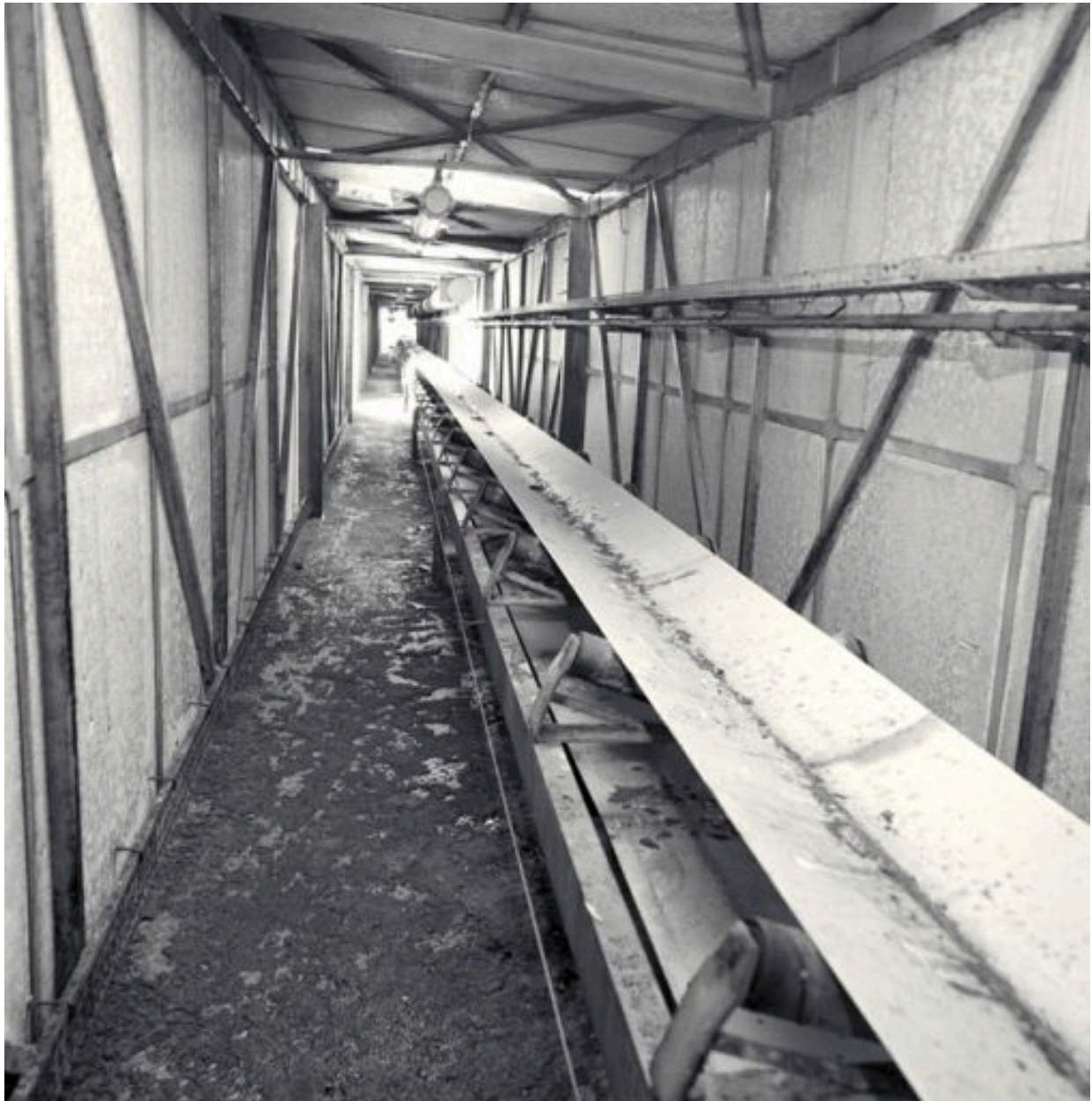
La galerie aérienne entre les silos et les ateliers : vue du transporteur à bandes vers les silos
