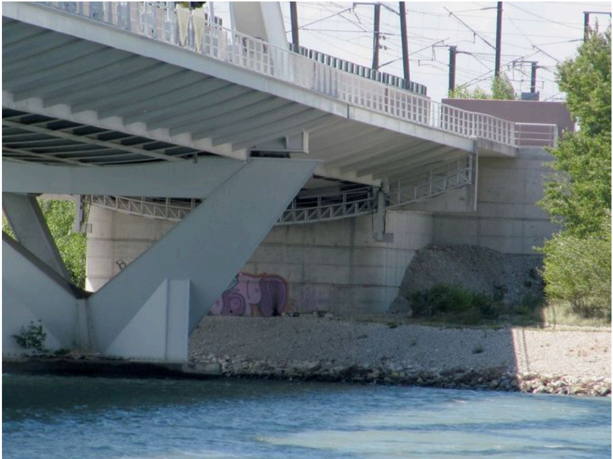
Culée droite, de côté, face amont, vue générale (depuis la rive gauche)
