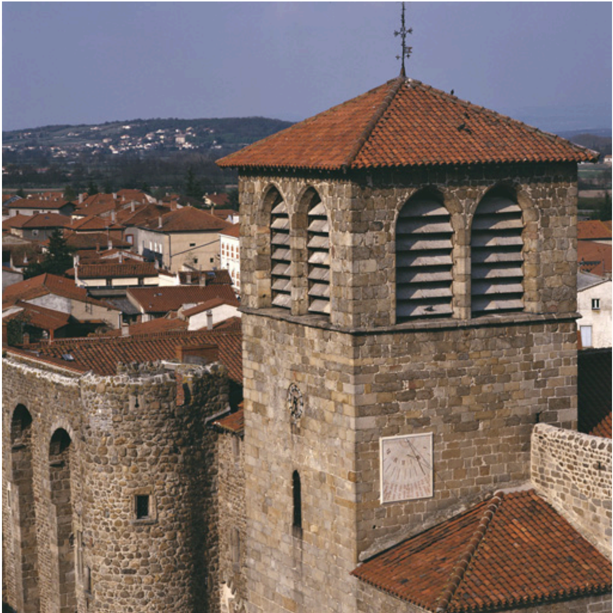
Vue des niveaux supérieurs du clocher porche et de l'aile ouest des bâtiments conventuels, depuis une grue placée au sud-ouest.
