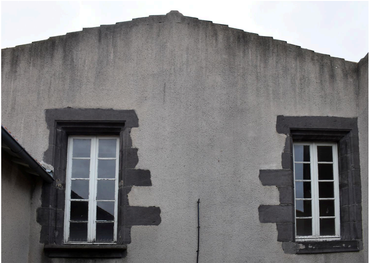
Corps de bâtiment sud, élévation sur cour : détail des baies du 2e étage
