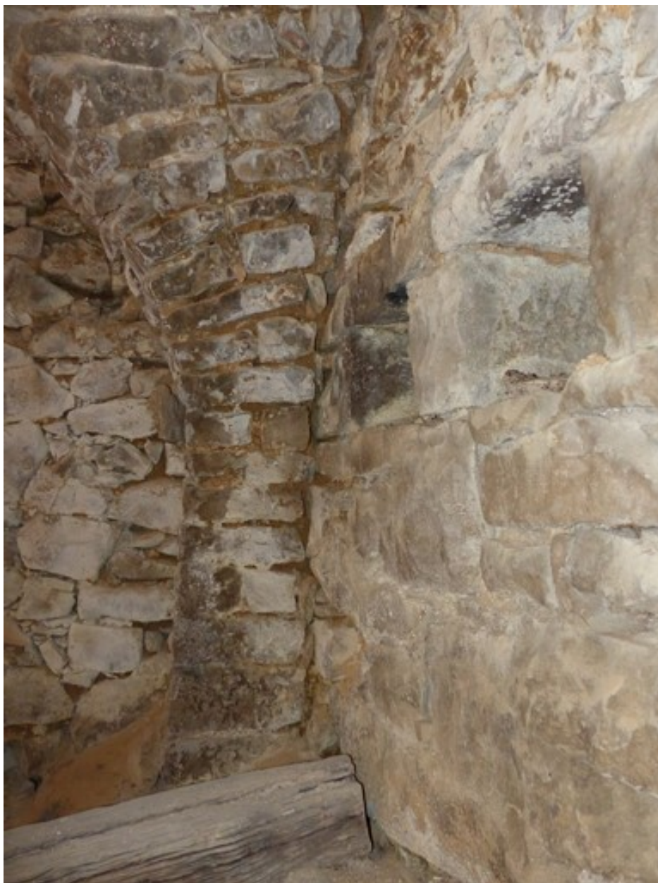
Etage de soubassement, étable. Angle sud-ouest, collage de la voûte.
