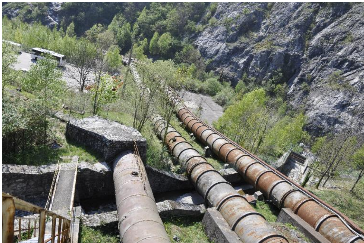
Vue des conduites forcées
