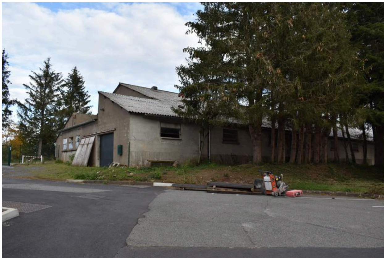
Bâtiment d'exploitation, dit du Marchedial, situé au nord de l'édifice. (Photo chercheure.)
