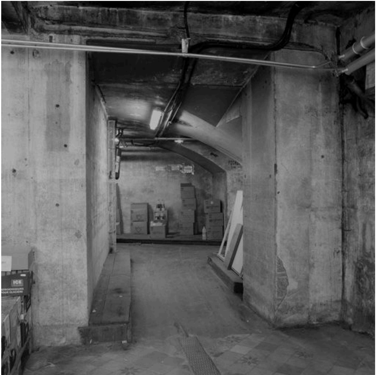
Sous-sol rue Tupin : vue du passage sud vers le couloir central, depuis l'ouest
