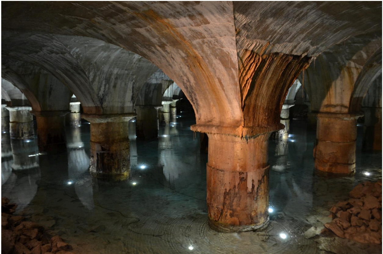
Vue des bassins filtrants
