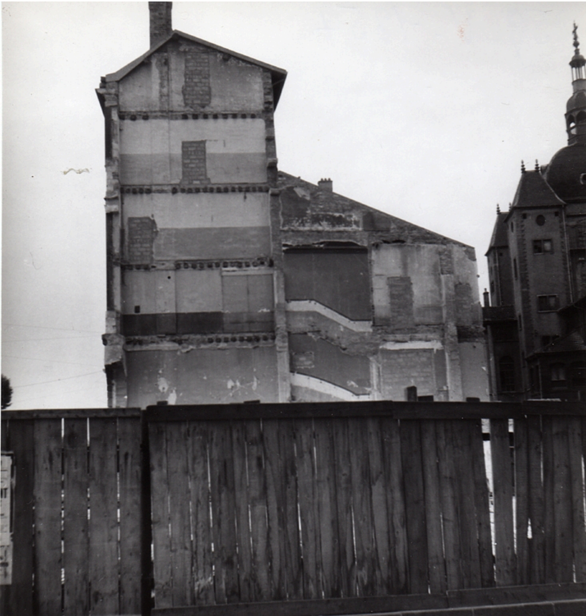
Démolition du passage, l'espace libéré au niveau des deux corps de bâtiment N
