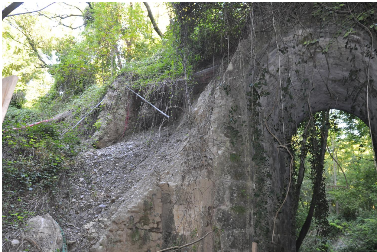
Détail du mur tympan effondré, rive ouest, de la face amont du vieux pont
