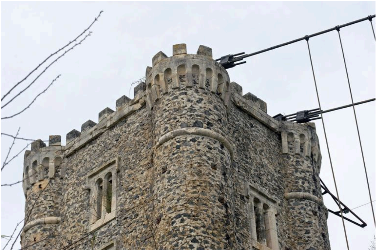
Tour formant tête de pont sur la rive droite : vue des parties hautes
