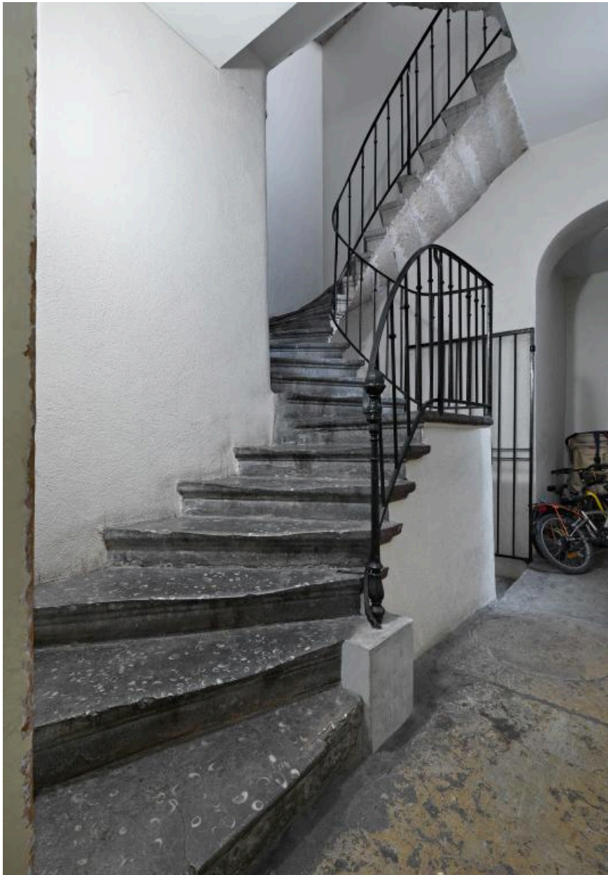
Vue intérieure, le départ de l'escalier, dont la première volée est en retour d'équerre
