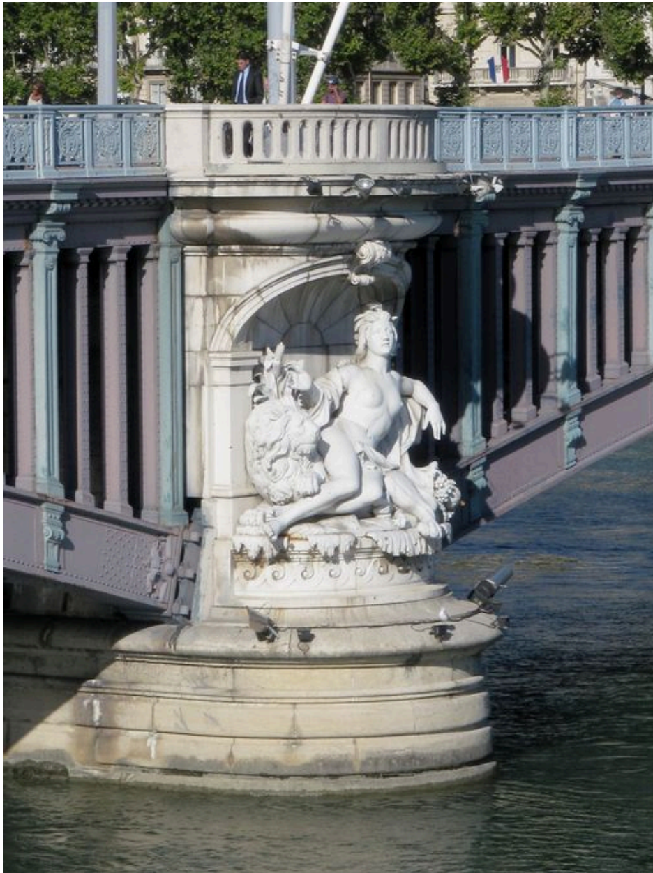
Pile avec statue de la Saône, face aval, vue générale : de face (depuis la rive droite)
