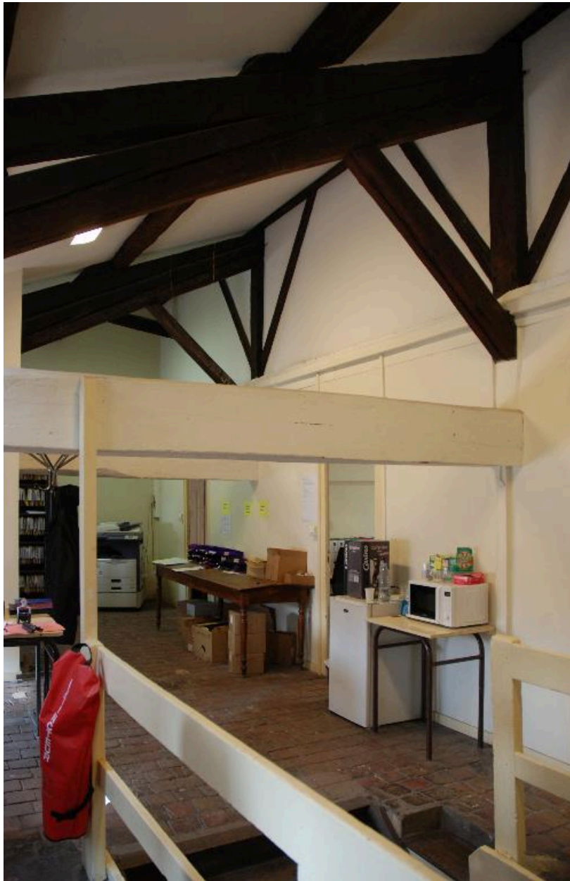
Cour d'honneur, corps de bâtiment est : comble, partie aménagée, depuis le sud
