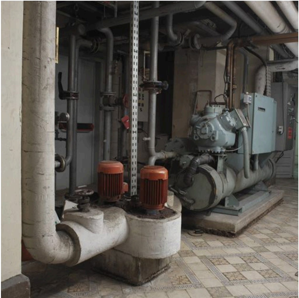
Sous-sol rue de la République, salle des machines : la pompe à eau glacée
