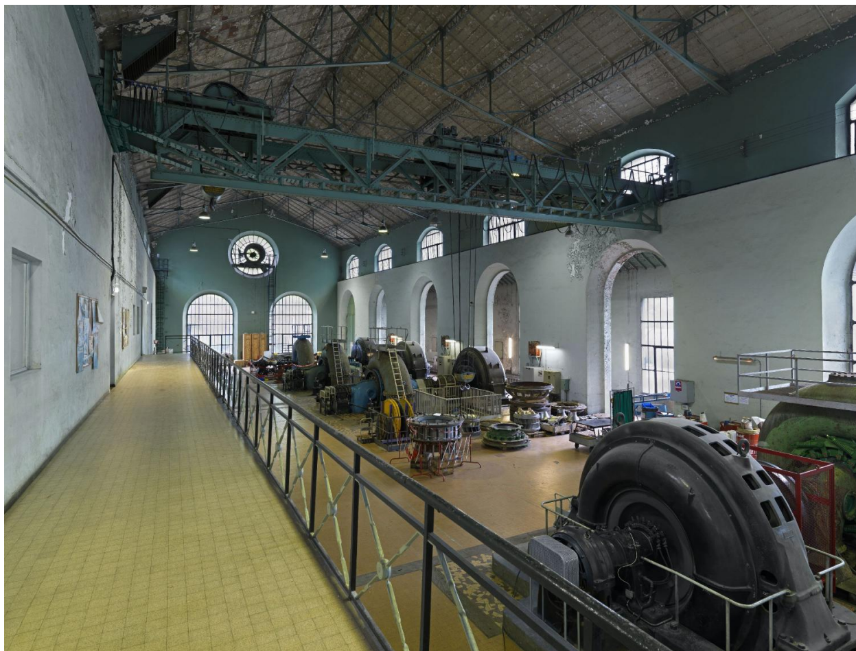
Vue intérieur de la centrale
