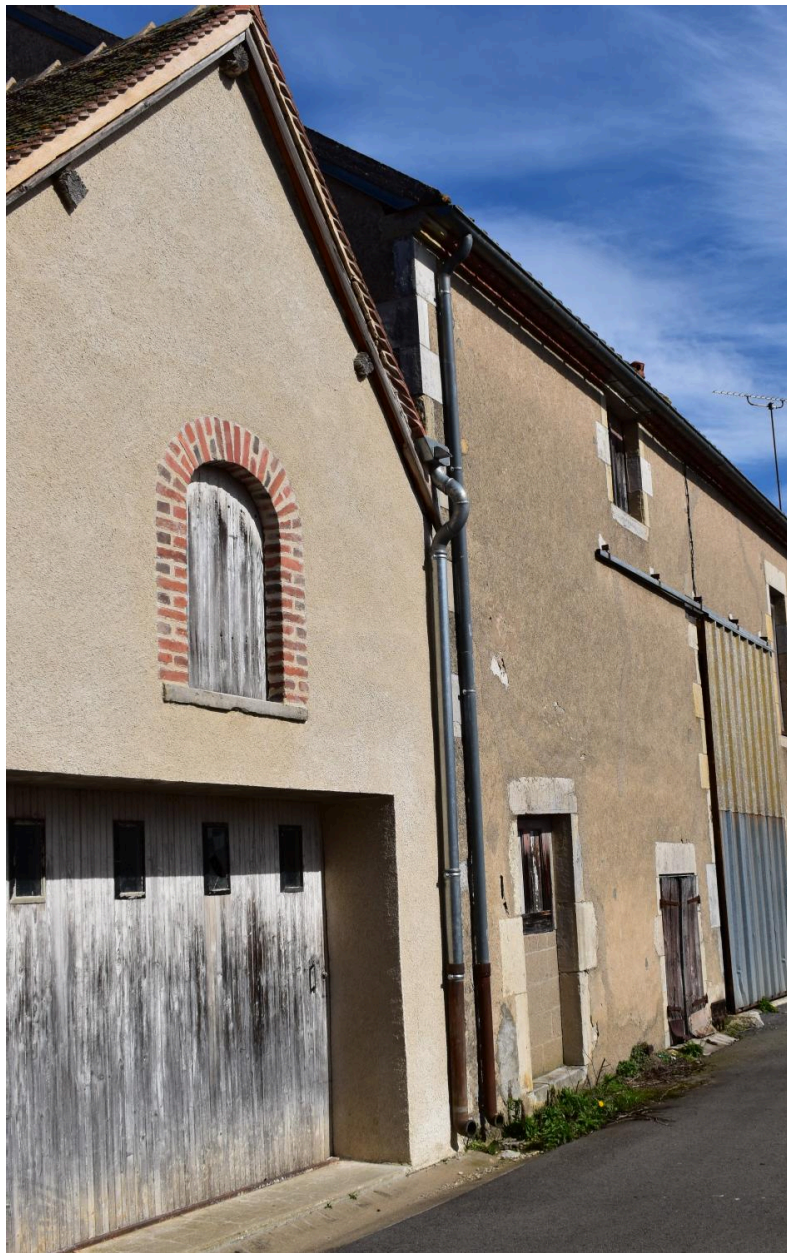
Détail du pignon du bâtiment de la parcelle 1341 sur la rue du Trou Gandou, actuellement salle d'exposition. En 2024, avant restauration de 2025.
