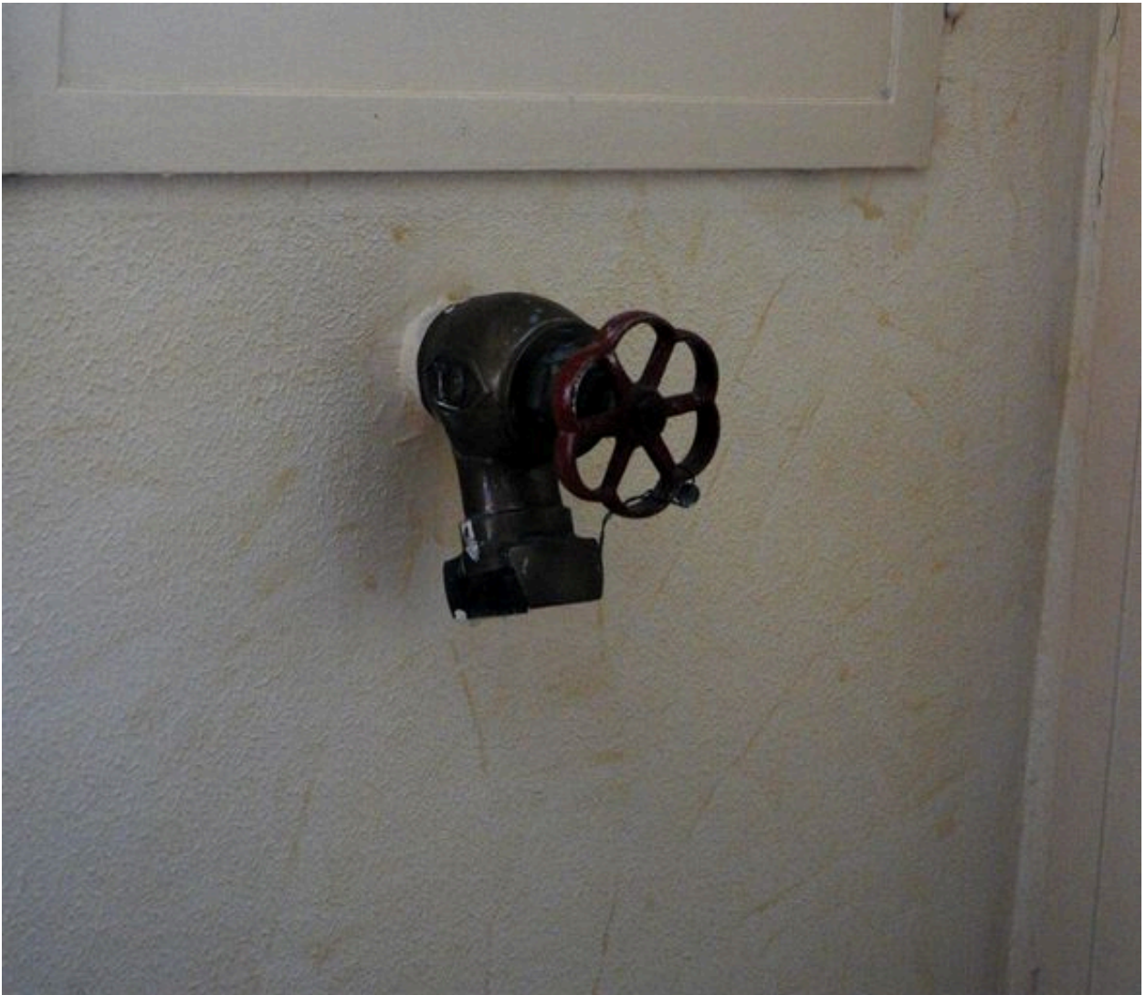
Vue de la vanne des eaux dans l'escalier
