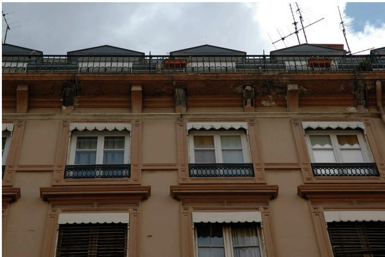
Elévation antérieure : détail de corbeaux en mauvais état
