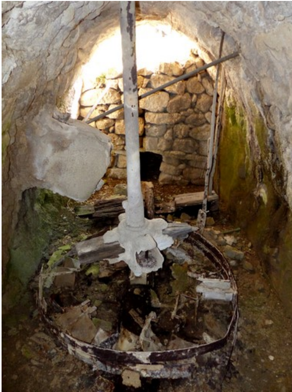
Bâtiment principal. Premier étage de soubassement, chambre de la roue. Vue de volume prise du nord.
