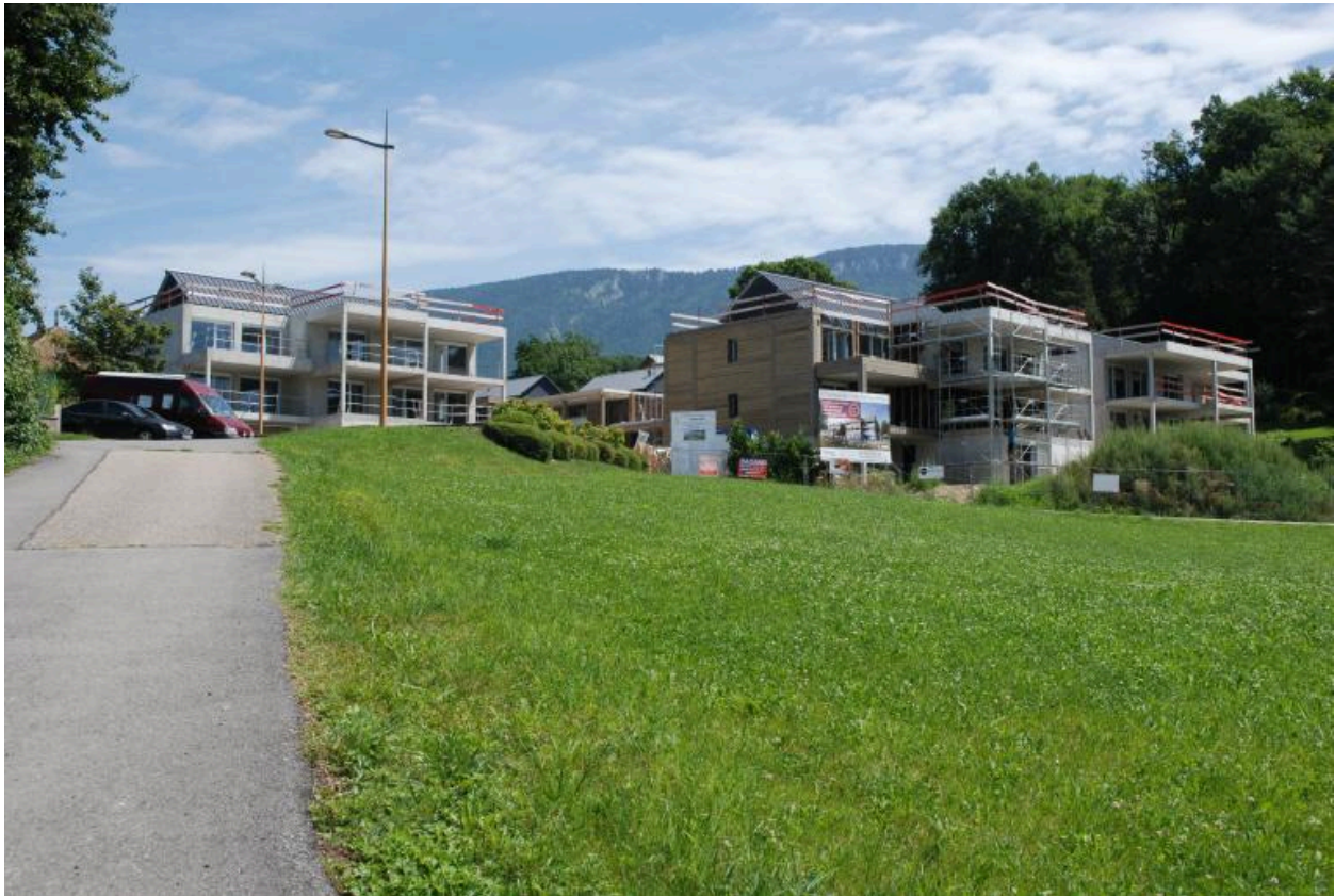
Vue des immeubles d'habitation collective en cours de construction en 2017 (2017 B4 138, 364, 576 à 578, 592, 593).
