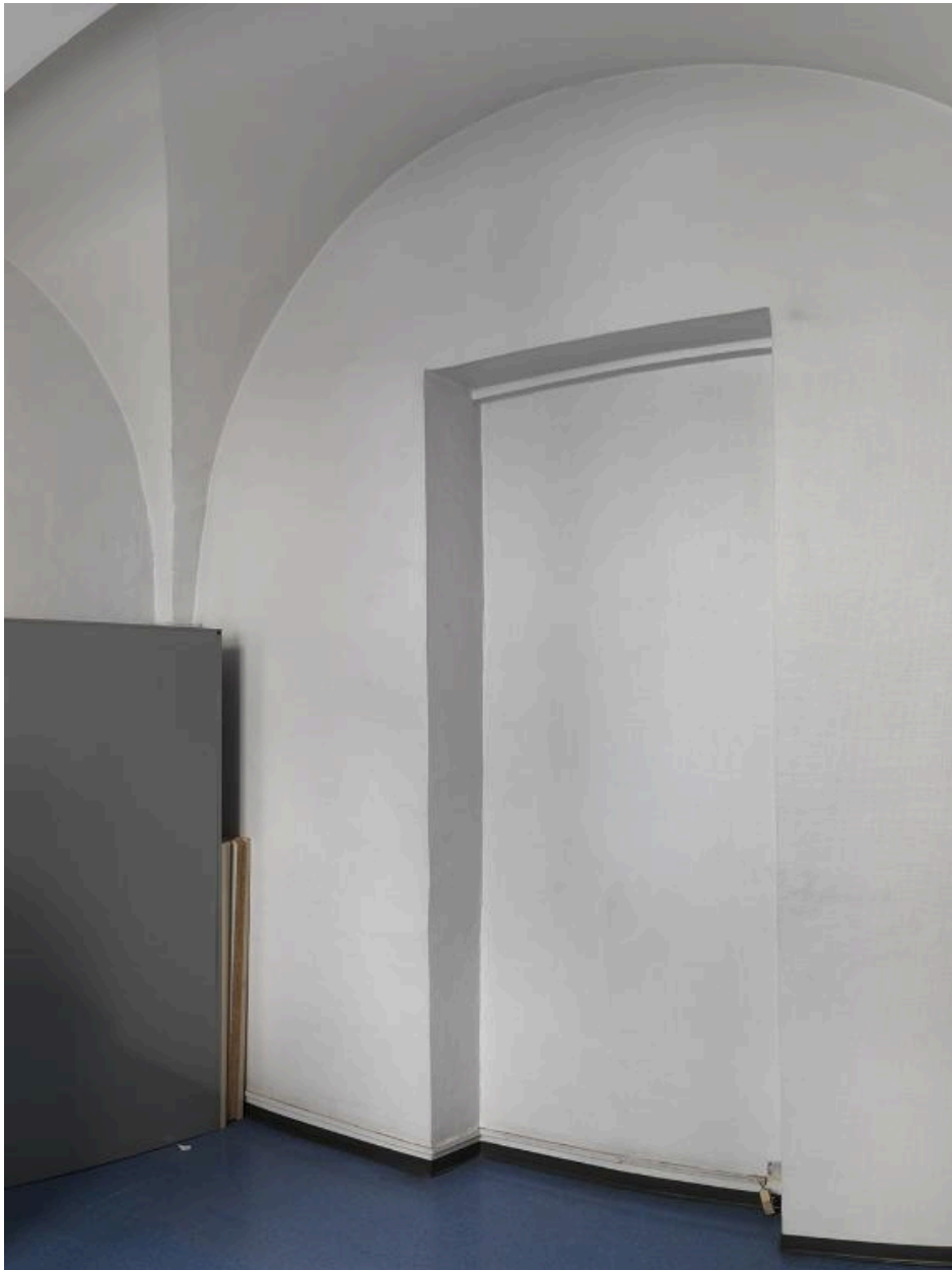
Corps de bâtiment sud, 1er étage, pièce de dégagement entre le passage Ménéstrier et l'escalier E
