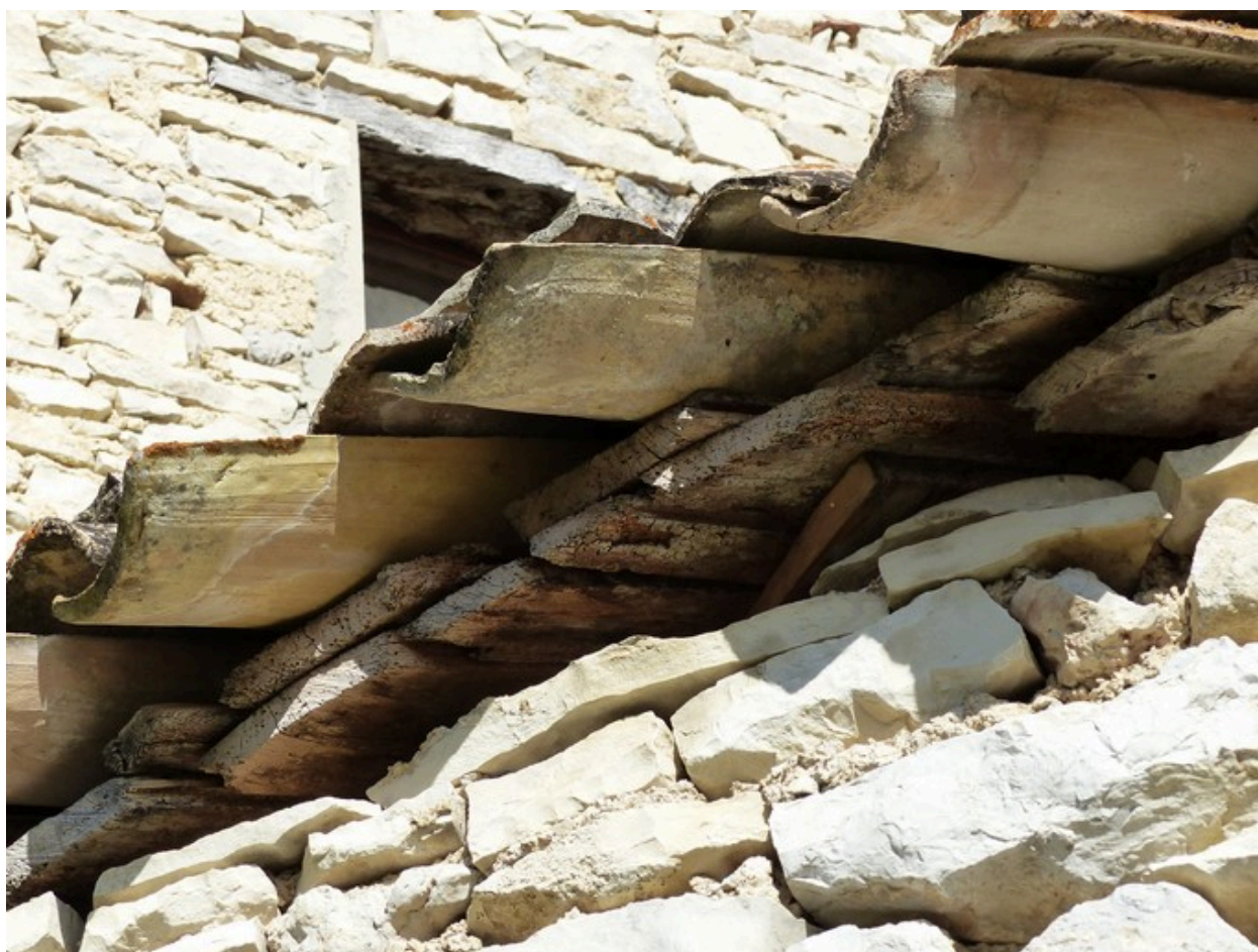
Etable à cochon, plancher de couverture.
