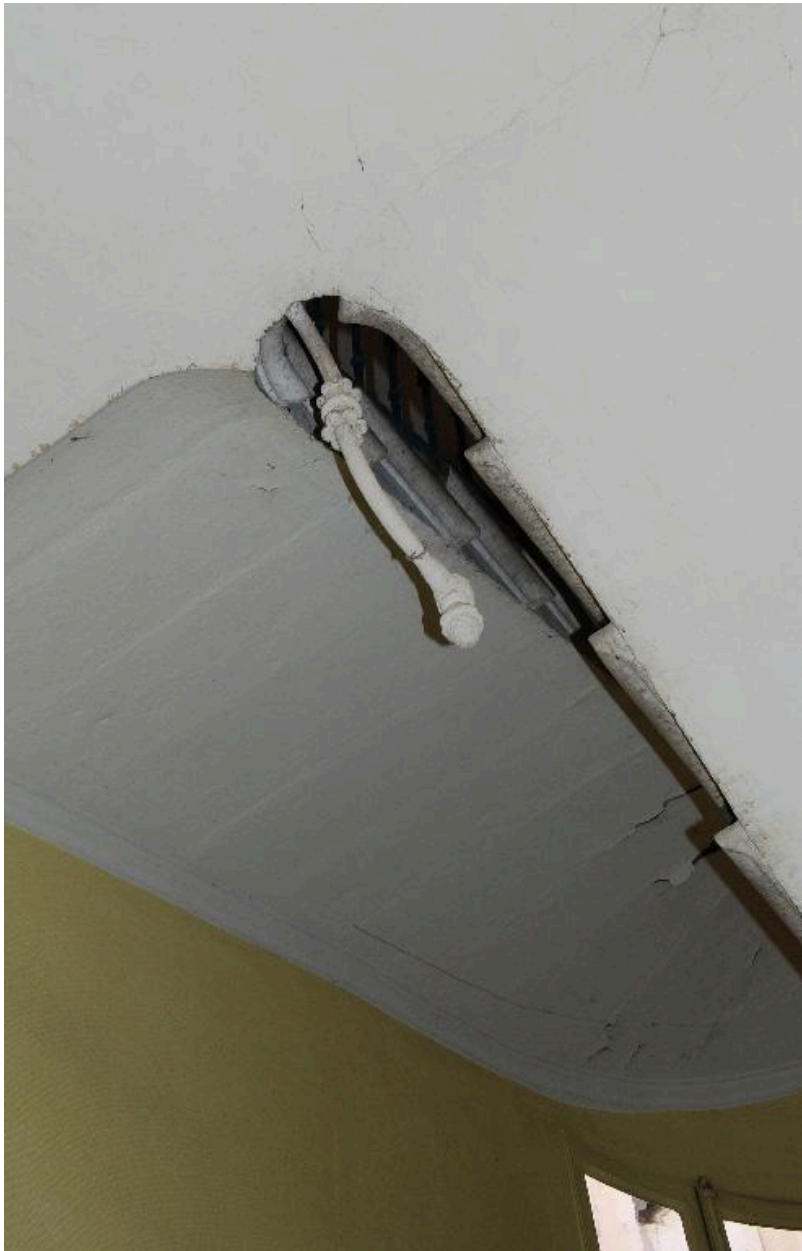
Détail d'un bec de gaz, sur le palier de l'escalier
