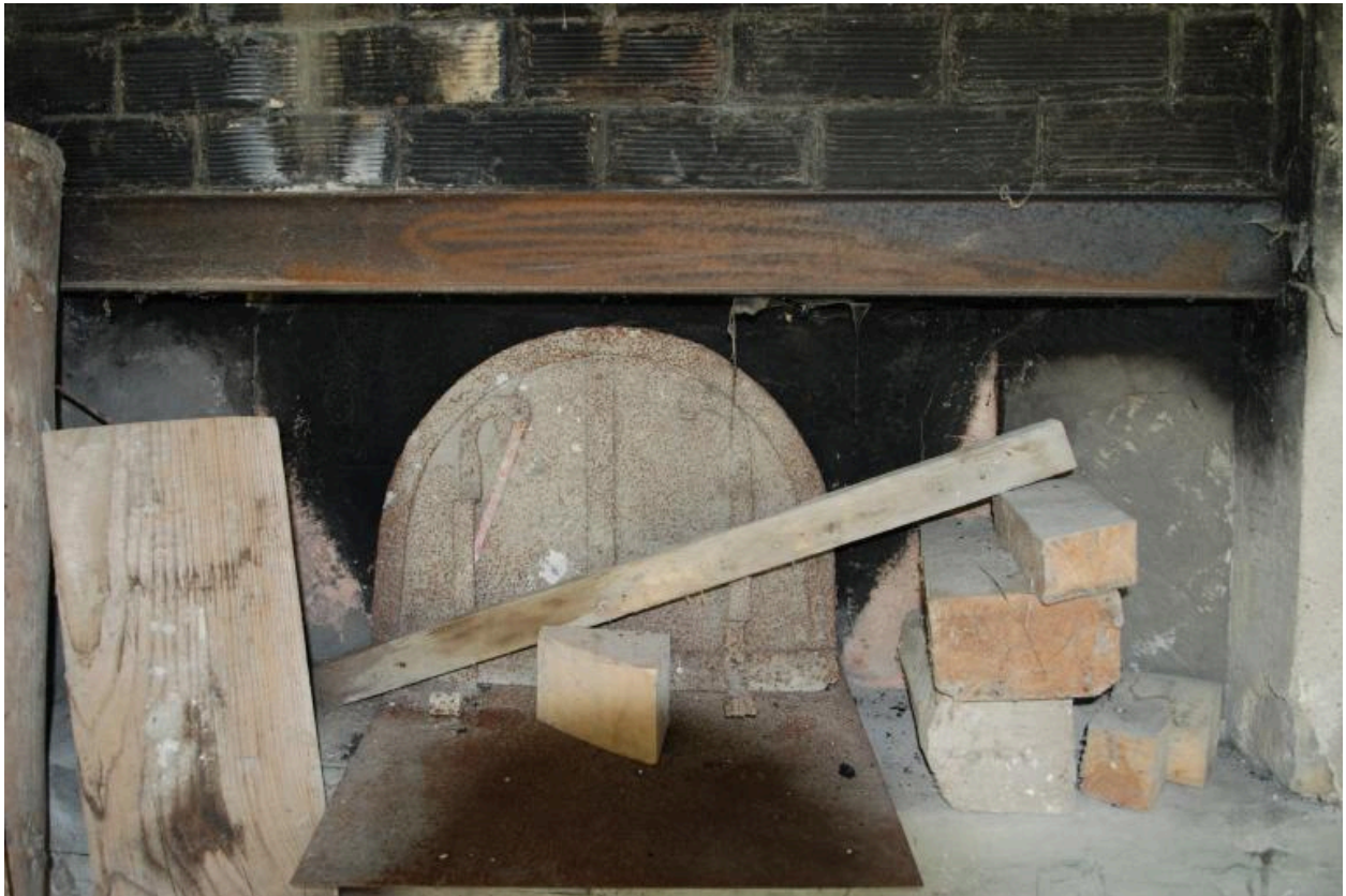
Détail de la bouche du four
