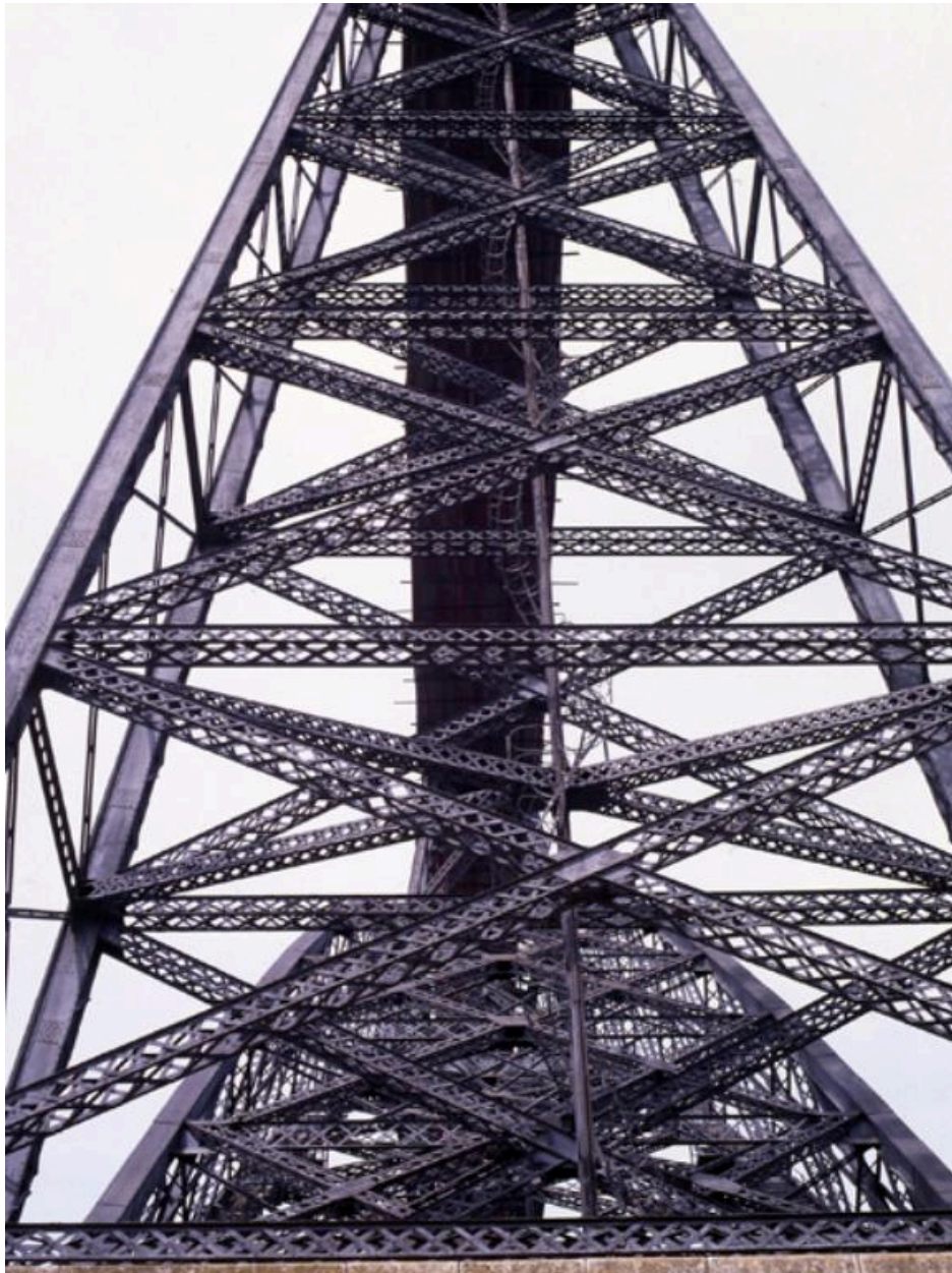
Détail de la structure métallique de l'une des piles du viaduc, vue en contre-plongée.
