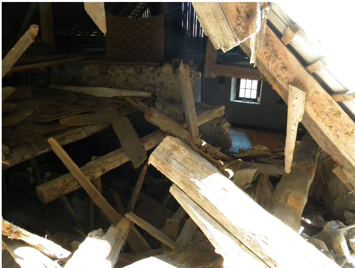
Vue du logis à travers la partie effondrée.
