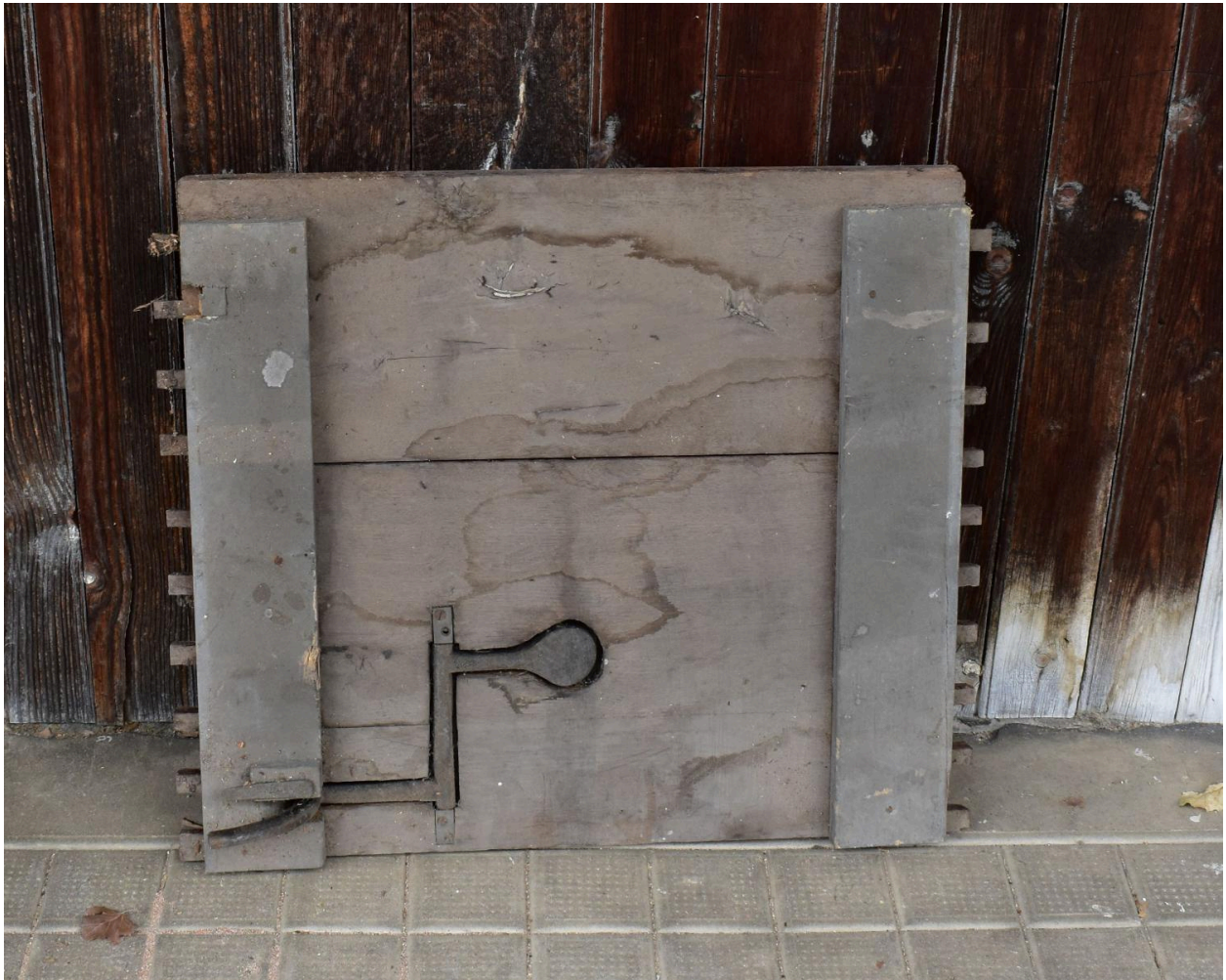
mécanisme de chasse d'eau incomplet
