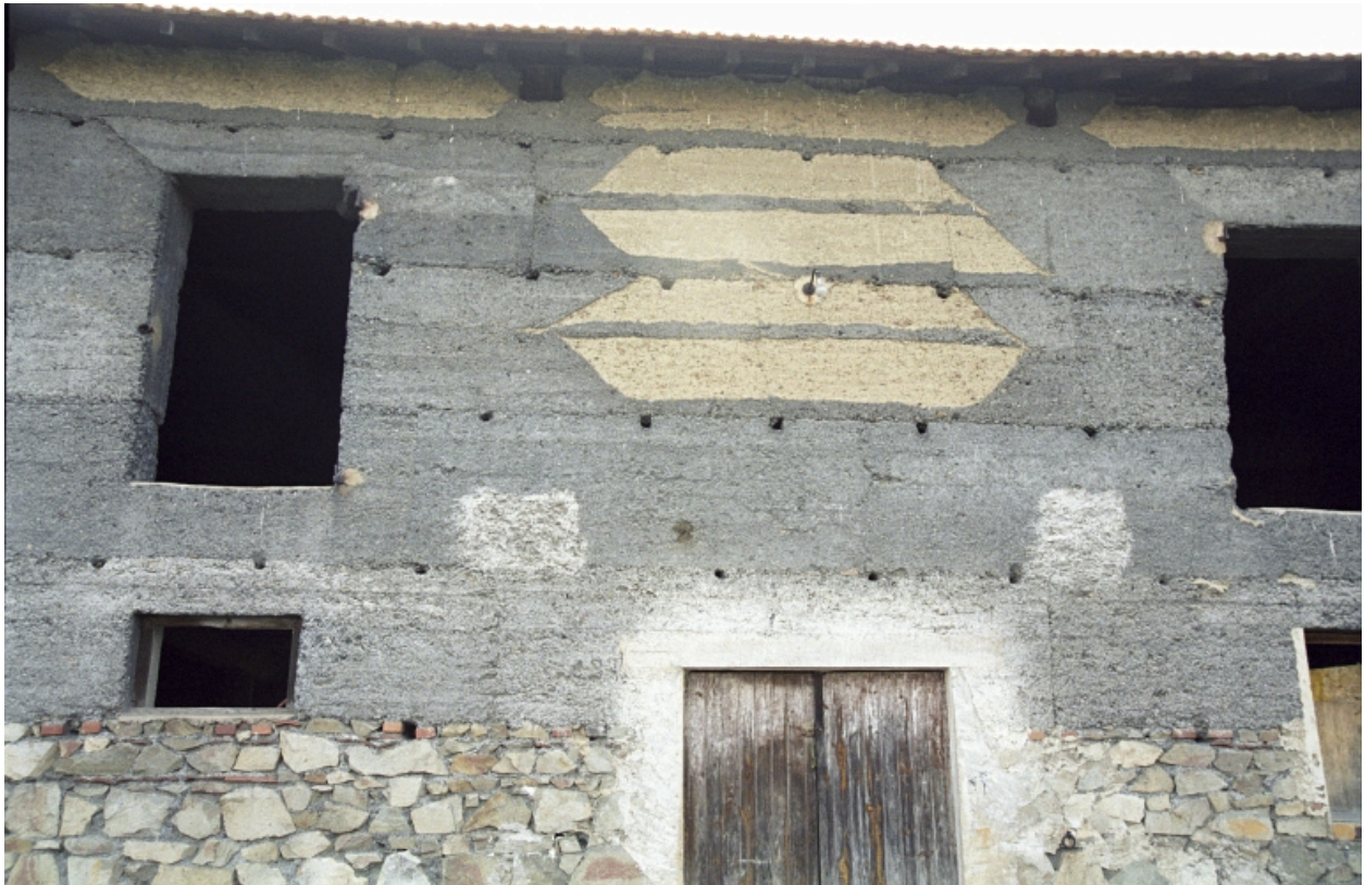
Boën, la Chaux-est, ferme (1986 AE 294).Grange-étable, pisé de terre et pisé de mâchefer (milieu 20e siècle).
